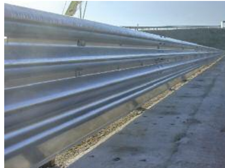
Figura 2 - Aspetto della barriera montata
